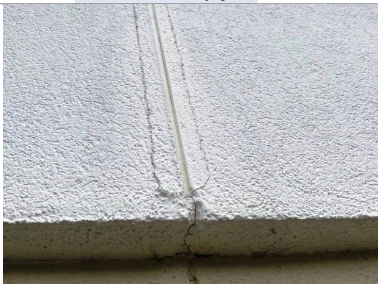
Afb. 21 Ter hoogte van de woningscheidende muren zijn aan de buitengevels dilataties toegepast met een speciaal dilatatieprofiel. Dit profiel beschikt over twee vleugels, waarop momenteel ook scheurvorming zichtbaar is. Deze scheuren worden veroorzaakt door uitzetting (daarom is er een dilatatie is aangebracht), thermische belasting (bezonning) en het afnemen van de flexibiliteit van de mortel.
