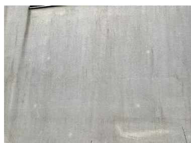
Afb. 19-20 Diverse geveldelen zijn sterk vervuild, vaak door algen en/of schimmels. Dit betreft meestal geveldelen die minder door de zon worden belast, aangezien Uv-straling normaal gesproken algen afbreekt. Het gaat daarom vaak om de noordgeoriënteerde geveldelen. Het betreft echter voornamelijk een esthetisch euvel; technisch gezien heeft deze vervuiling normaal gesproken geen invloed op de prestaties van het systeem.
