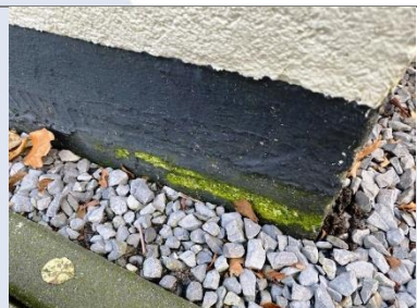
Afb. 45 Ondanks de aanwezigheid van een grindkoffer (wat zeer wenselijk is) is ook hier het gevelsysteem beschadigd, wat zich weer uit in onthechting. Waarschijnlijk was deze stuc laag al aangetast voordat de grindkoffer werd aangebracht.
