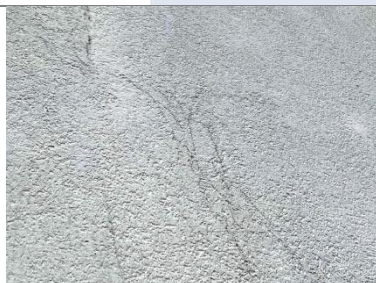
Afb. 44 Willekeurige scheurvorming. Dit betekent dat deze gevel op geen enkele manier meer in staat is spanningen op te vangen. Zie ook de toelichting bij de bovenstaande foto's.
